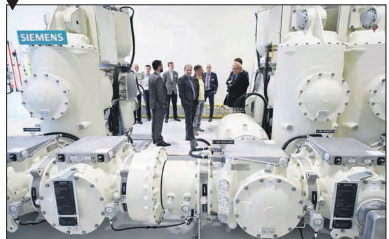
Intérieur du poste électrique de Moudon
